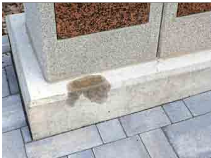
Ölfleck am Sockel der Urnenwand
