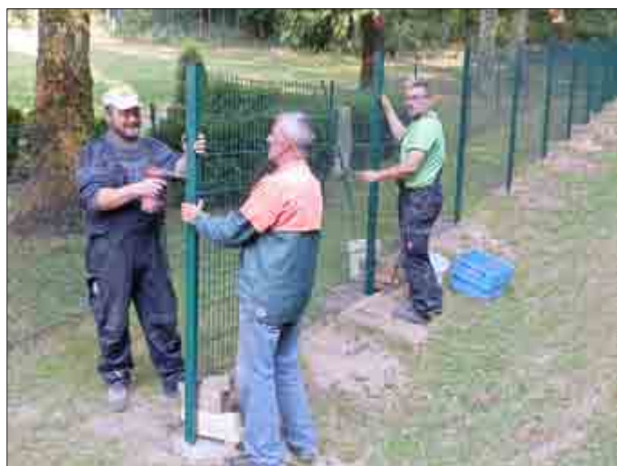
Mitarbeiter der Fa. Schrön - Metall- und Zaunbau Gerstungen bei der Ausführung der Zaunbauarbeiten am Friedhof Dippach
